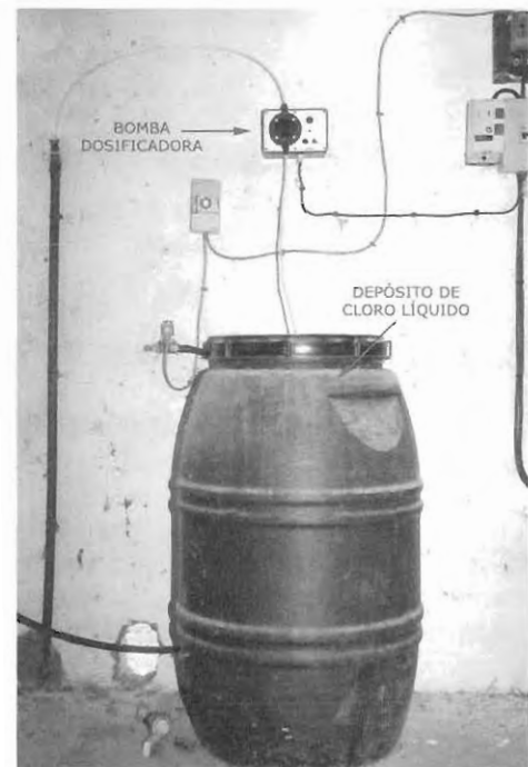
Bomba dosificadora y depósito de cloro líquido
