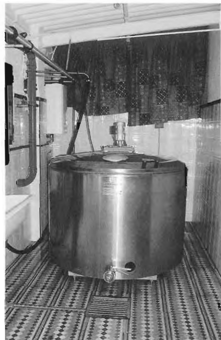
Lechería con terminaciones correctas
