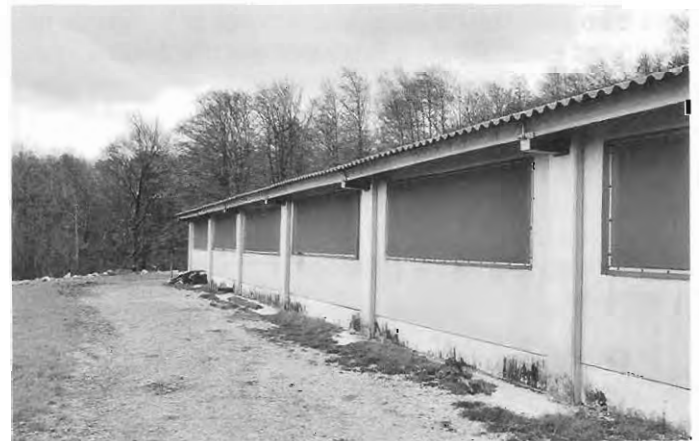
Área de reposo con terminación exterior realizada con pintura plástica. En las ventanas se ha colocado rejillas de plástico para controlar la velocidad del aire
