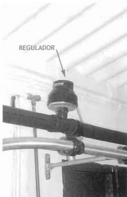
Regulador de vacío de gran caudal colocado sobre tubería de vacío de P.V.C.
