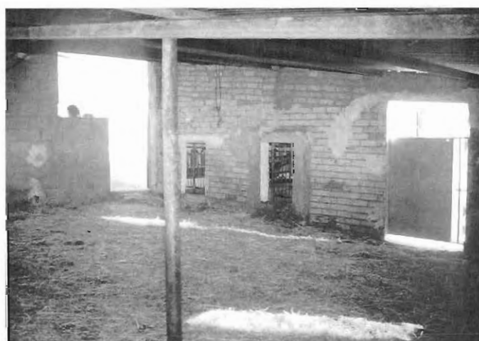
Corral de apriete en explotación caprina junto a sala de ordeño. Cerramientos sin enlucir difíciles de limpiar.
