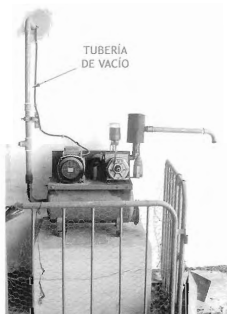
Grupo moto bomba y tubería de vacío en acero galvanizado
