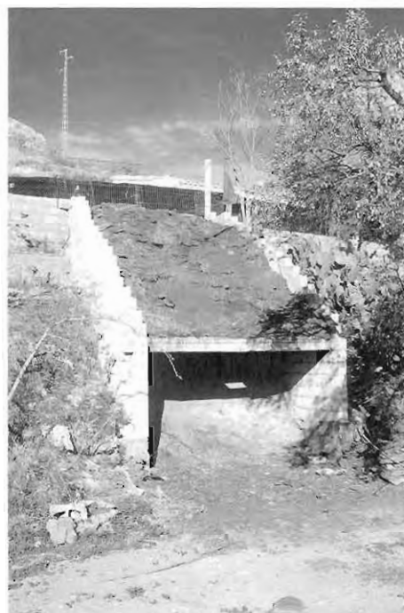
Sistema de almacenamiento de estiércol para su posterior empleo agrícola
