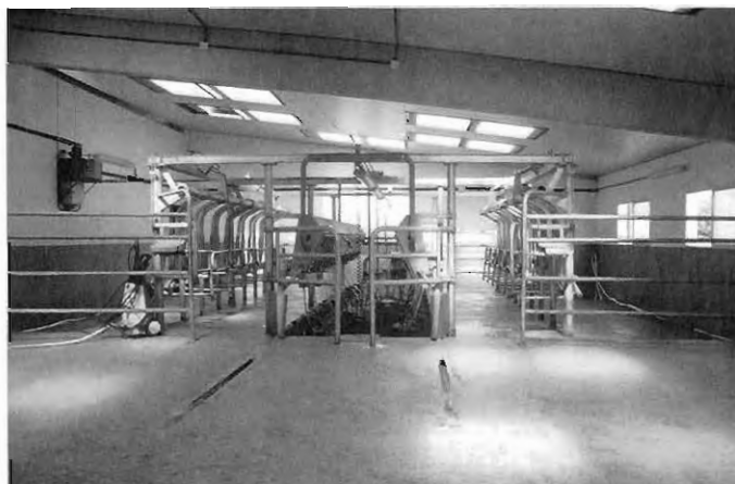
Embocadores metálicos de separación entre sala de espera y ordeño
