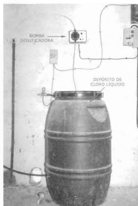
Bomba dosificadora y depósito de cloro líquido
