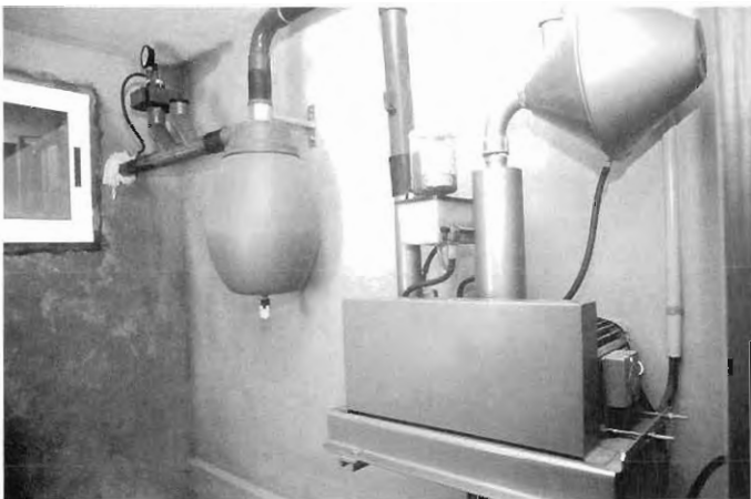
Grupo moto bomba para generar vacío en un equipo de ordeño mecánico
