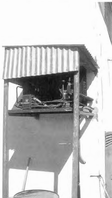
Grupo frigorífico en el exterior de la lechería para mejorar la eficiencia de la refrigeración, reduciendo el gasto eléctrico
