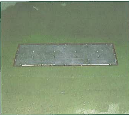
Foto nº 18: Los suelos deben poseer desagües apropiados
