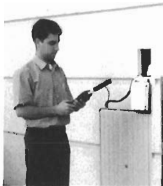
Lectura de los contadores en una sola toma en el exterior del recinto de la agrupación
