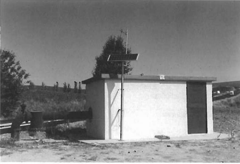
Esta fotografía muestra la caseta del hidrante donde se montó el terminal remoto. En el mismo mástil se instaló el panel fotovoltaico y la antena direccional.
