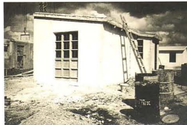
(Derecha) Sistema "FC2" construcción con paneles de poliestireno expandido con mallas electrosoldadas realizados en la planta de FUCVAM y protegidos con mortero proyectado. Cooperativa "COVIFOEB". Instituto "COVIMA".
