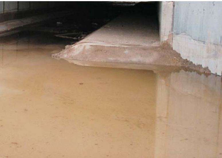
Figura 3. El deficiente diseño de las aceras provoca su aislamiento en las ocasiones en que el drenaje lleva algo de agua (drenaje sobredimensionado de la autovía A-231).
