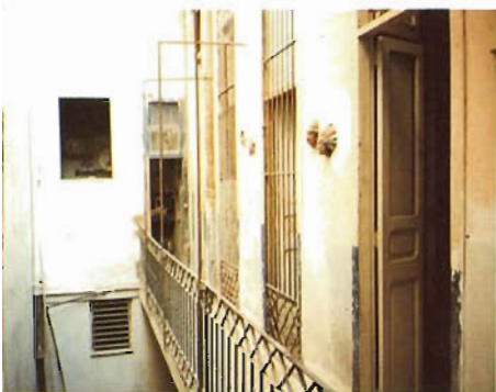
INTERIOR OF BUILDING BEFORE REHABILITATION IN THE MALECÓN. MALECÓN Nº 27 Proyecto Malecón Cuba+España. Sevilla
