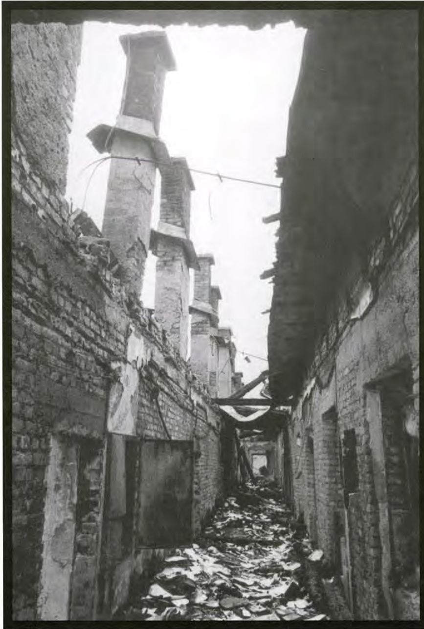
Instituto de Cooperación Internacional Científica, Técnica, Cultural y Educativa, e Instituto Oriental (antiguo edificio del Fondo de Pensiones) - arquitecto Ludwig Huber - 1891 - calle Veljka Cubrilovica
