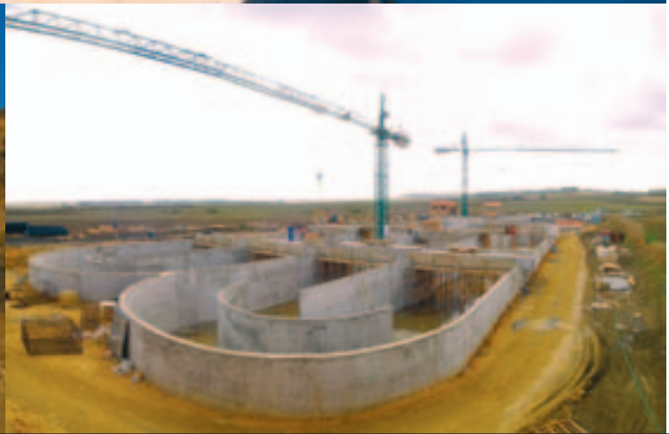
Construcción de agrupación de vertidos de Mairena del Alcor y El Viso del Alcor (Sevilla).
