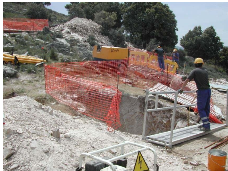
Ejemplo de protección incompleta, y por tanto incorrecta.
