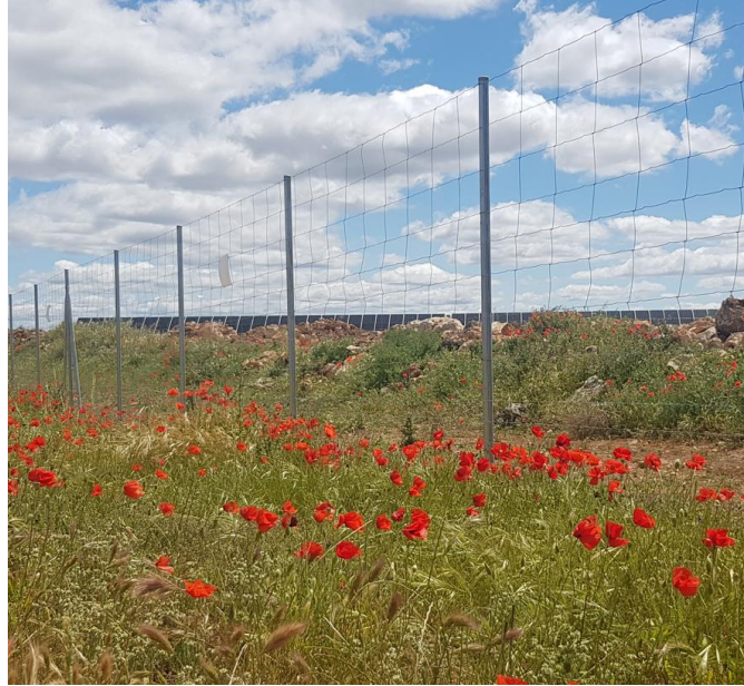
Figura 3.2.7.b. Vallado cinético para cierre perimetral. Fuente: Modificados de los Proyectos de Ejecución de las Plantas Fotovoltaicas Venta Angulo, Los Llanos y Las Canteras. TT.MM. Baza y Caniles (Granada).
