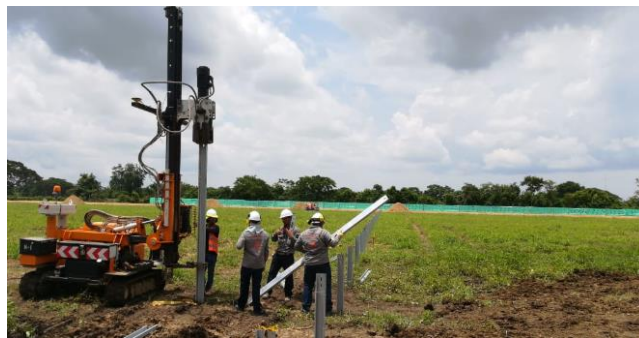
Figura 3.2.9.a. Hincado de perfiles con maquinaria especializada. Fuente: Modificados de los Proyectos de Ejecución de las Plantas Fotovoltaicas Venta Angulo, Los Llanos y Las Canteras. TT.MM. Baza y Caniles (Granada).
