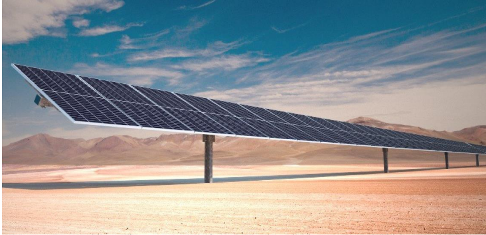
Figura 3.1.5.a. Seguidor Solar. Fuente: Modificados de los Proyectos de Ejecución de las Plantas Fotovoltaicas Venta Angulo, Los Llanos y Las Canteras. TT.MM. Baza y Caniles (Granada).
