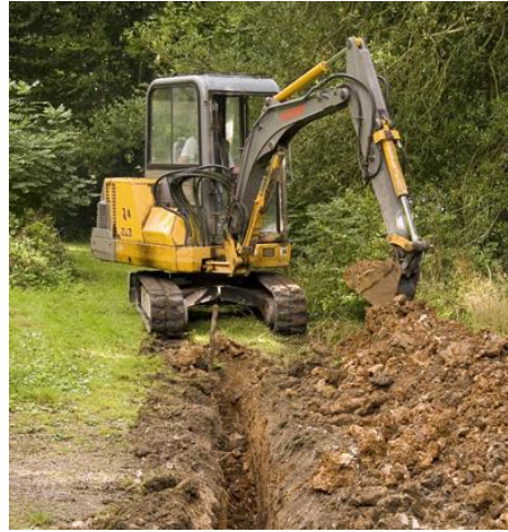
Figura 3.2.10.a. Excavación de zanjas. Fuente: Modificados de los Proyectos de Ejecución de las Plantas Fotovoltaicas Venta Angulo, Los Llanos y Las Canteras. TT.MM. Baza y Caniles (Granada).
