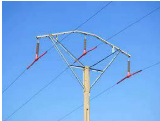
Figura 62. Forros avifauna en crucetas de suspensión
