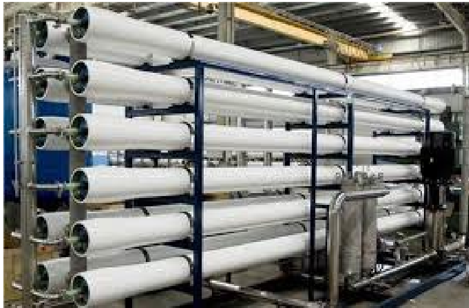
Figura. 5-26 Instalación de osmosis inversa.
