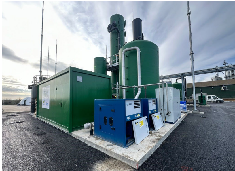
Figura. 5-13 Instalación de desulfuración. Fuente: Elaboración propia.
