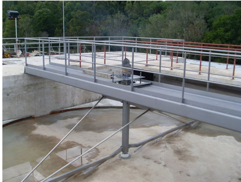
Figura. 5-8 Sistema de separación de arenas. Fuente: Virtus.
