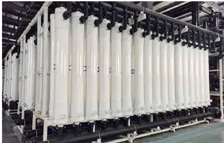
Figura. 5-25 Instalación de ultrafiltración.
