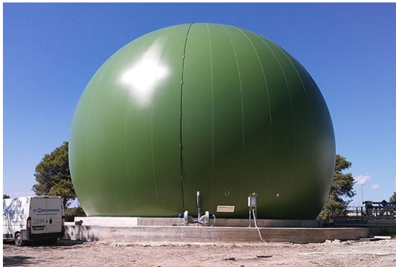
Figura. 5-11 Membrana de almacenamiento de biogás.
