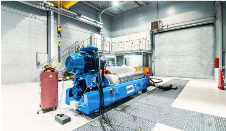
Sistema de separación sólido-líquido
