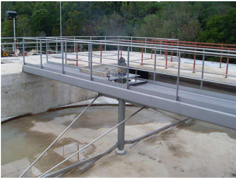
Sistema de separación de arenas
