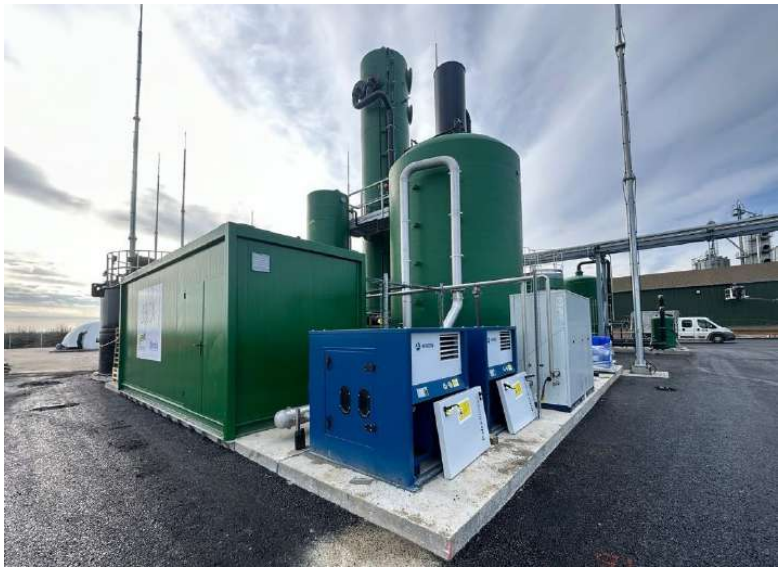
Instalación de desulfuración
