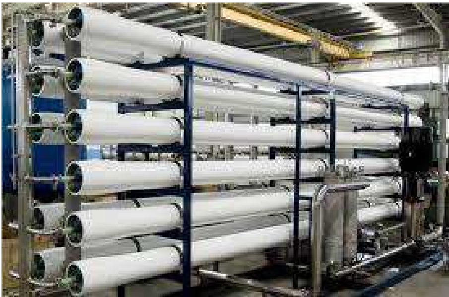
Instalación de ósmosis inversa.
