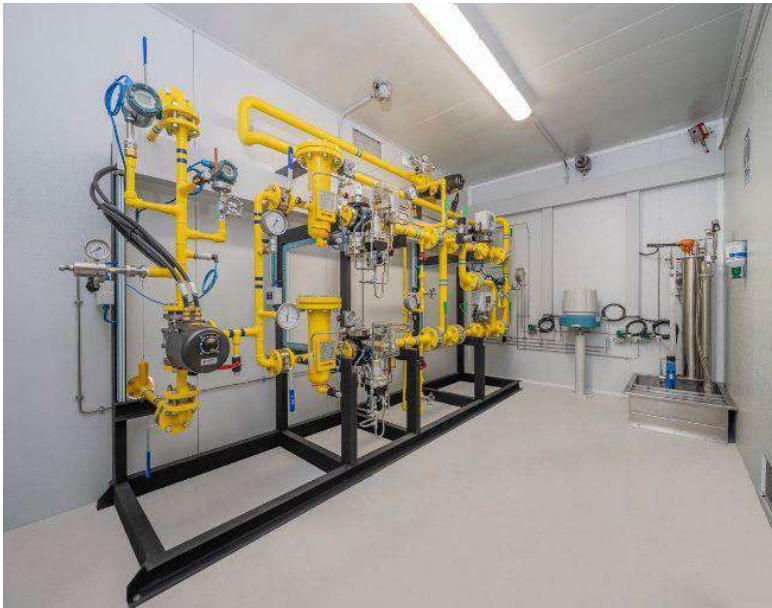
Módulo de inyección a red (Propio)
