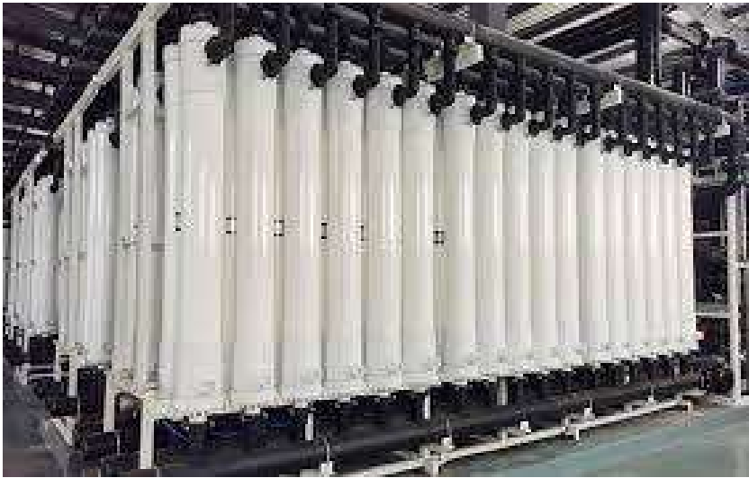
Instalación de ultrafiltración.
