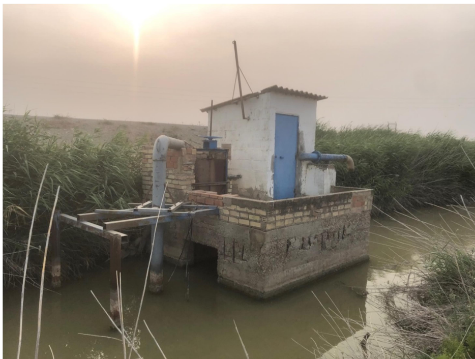
Caseta de bombeo para achique de agua "Casa Recreo".
