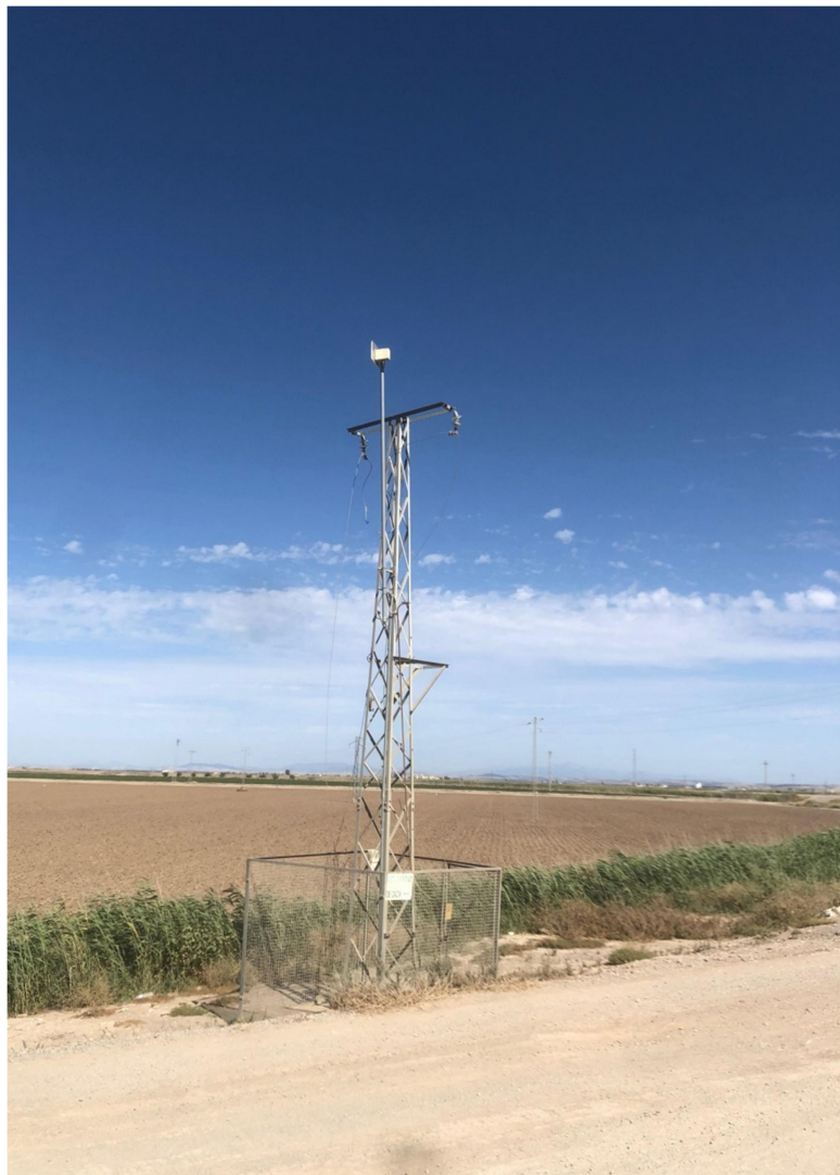
Apoyo eléctrico base de antena.
