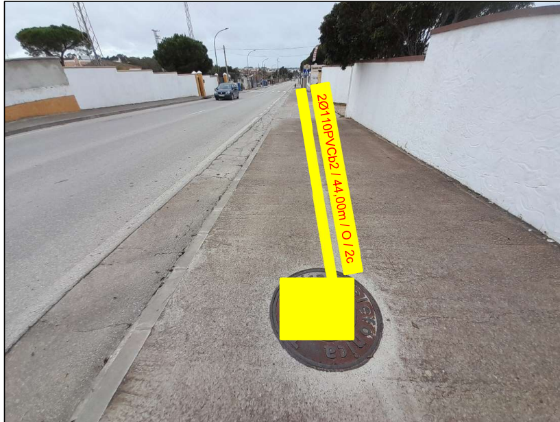
Imagen 1. Salida de la cámara de registro
