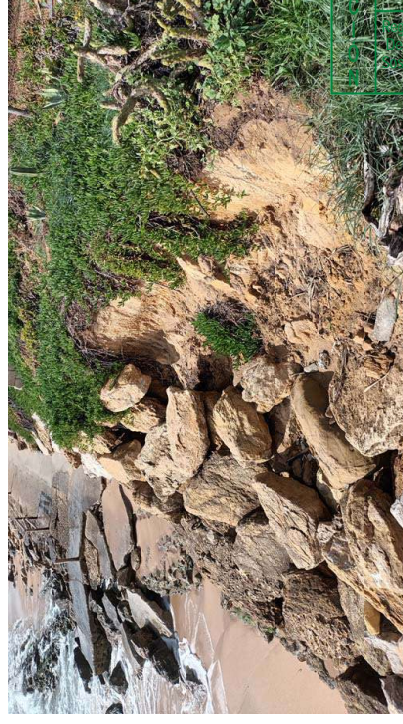
Figura 8. Muro de protección de escollera en el acantilado y daños por agentes climáticos (escorrenfías, etc.).
