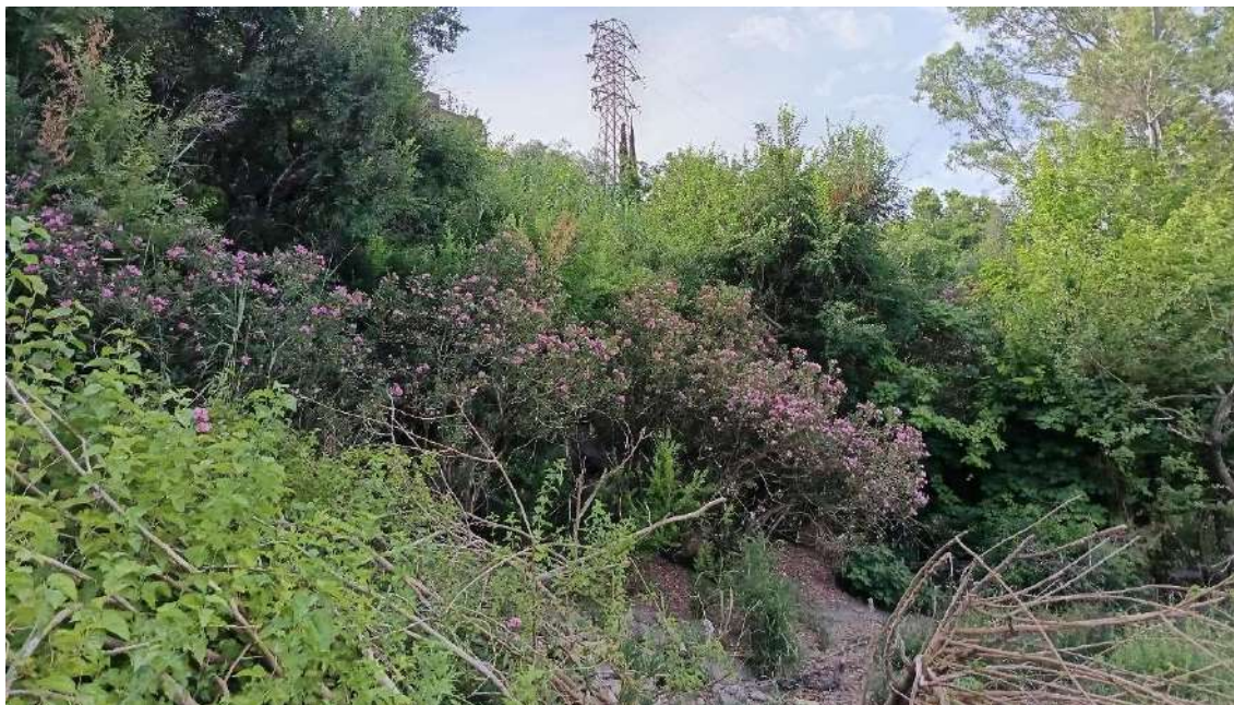
Figura 8. PK 0+070. Identificación de poste de línea eléctrica aérea de la subestación tras talud revestido de hormigón fragmentado con vegetación emergiendo de él.
