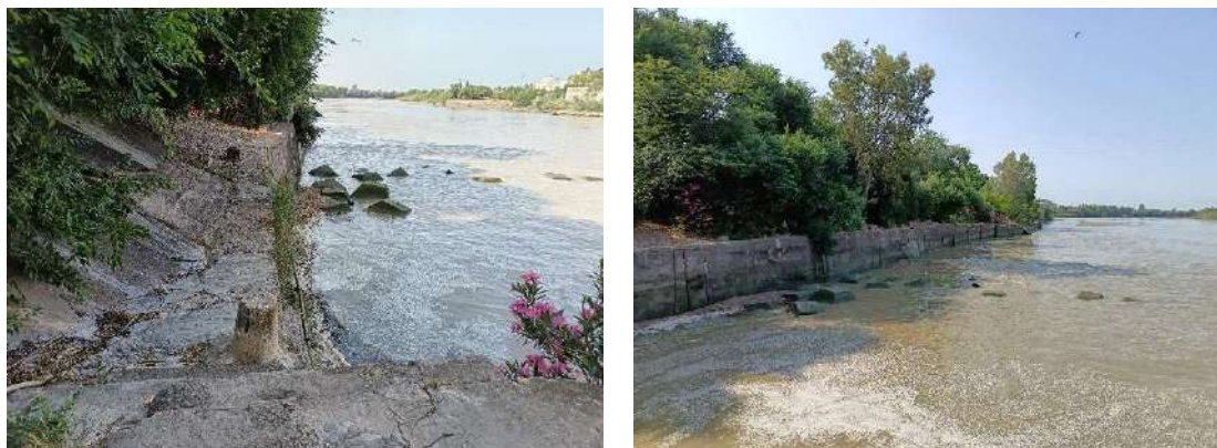
Figura 3. Elementos de protección del cauce, aguas abajo del canal de descarga de la central hidroeléctrica
