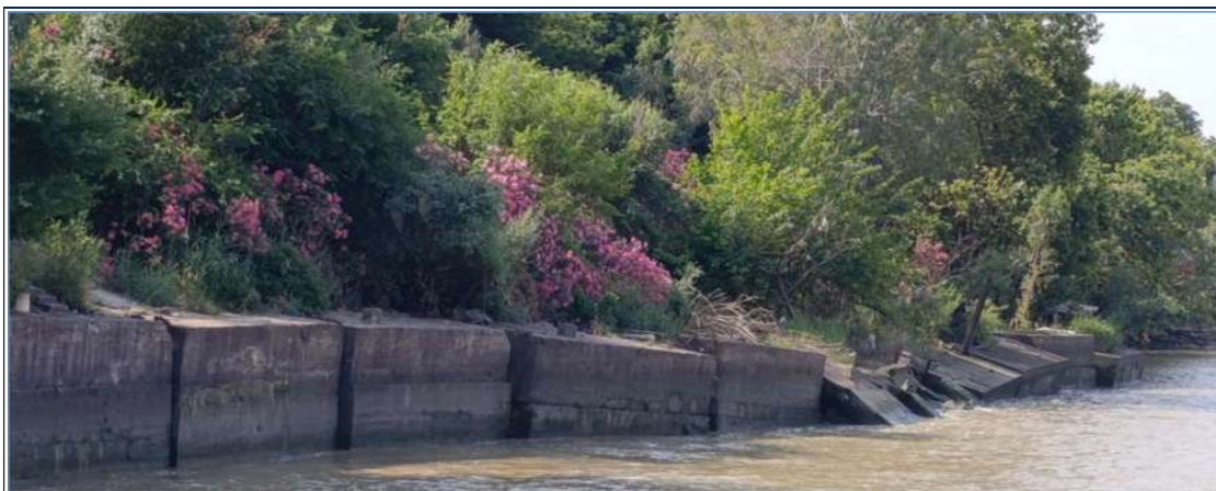
Figura 10. Estado dados de hormigón margen izquierda del río Guadalquivir en el entorno de la subestación eléctrica
