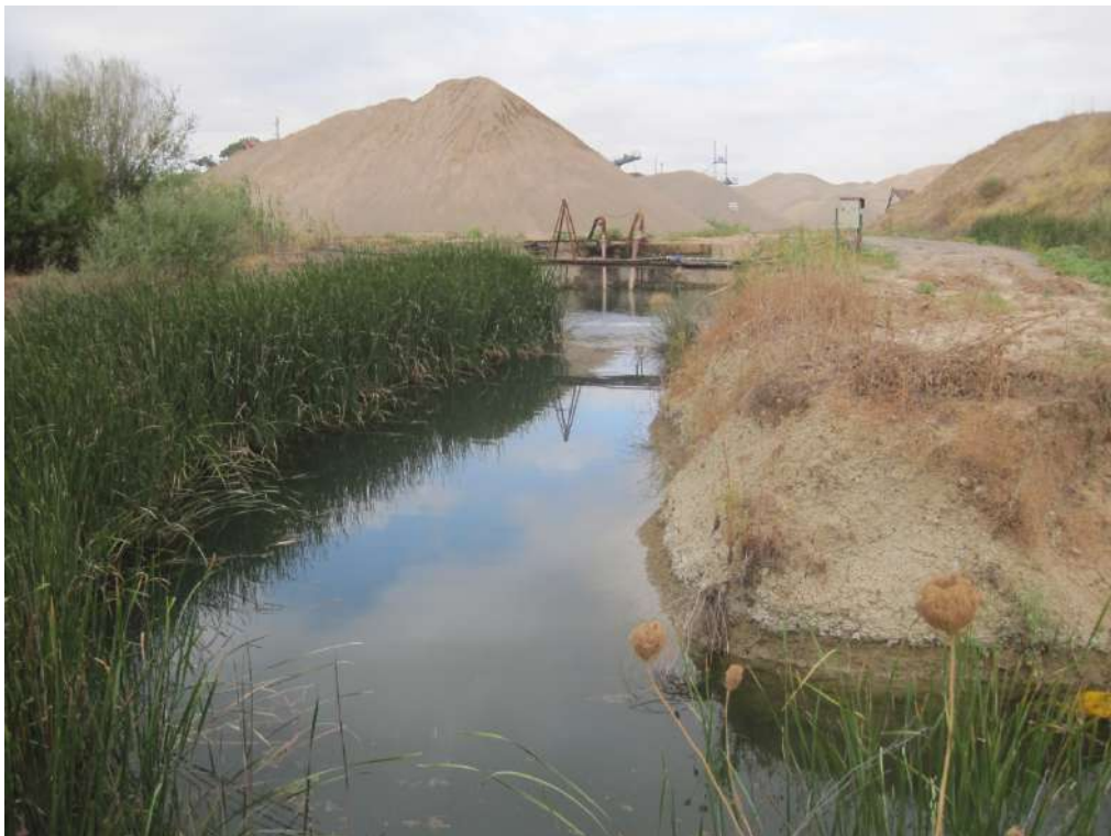
Excavación en margas de la charca de aguas limpias y la entrada del canal
