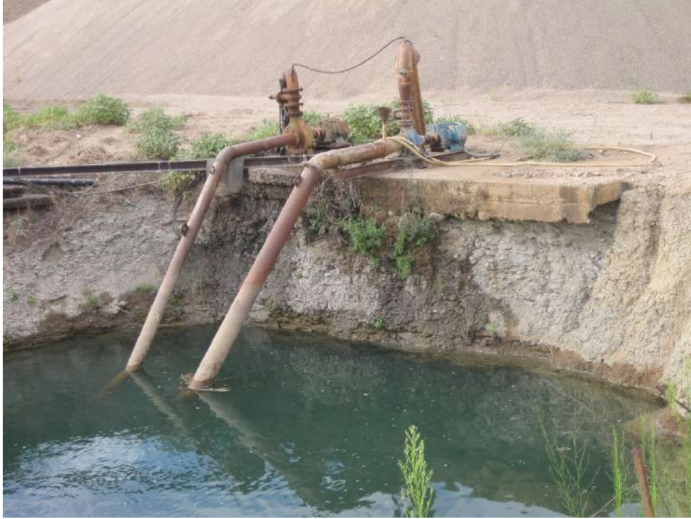
Bombas de aguas limpias
