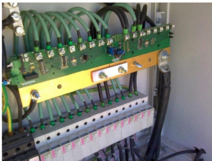
Imagen 26 Detalle sistema monitorización
