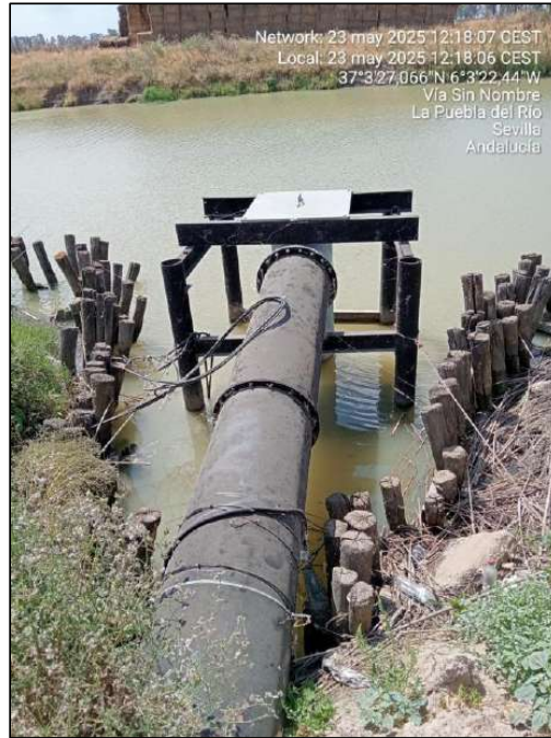
Fotografía 3: Captación de aguas y empalizada de defensa de margen del Brazo del Este.
