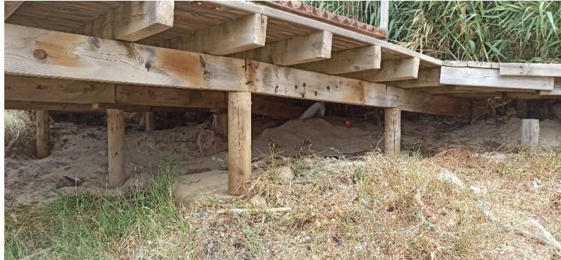
Ilustración 3. Tramo 2, Pilotes de cimentación del mirador desprotegidos.
