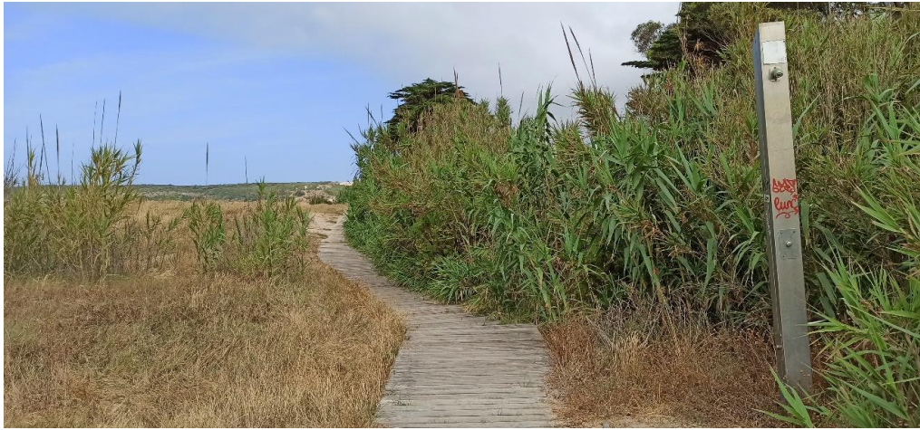
Ilustración 1. Tramo 1, pasarela en mal estado y vegetación invasora, caña común (Arundo donax).
