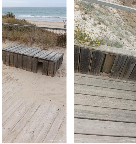
Ilustración 7. Ausencia de piezas en la carpintería.
