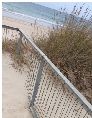
Ilustración 6. Pasamanos en mal estado.
