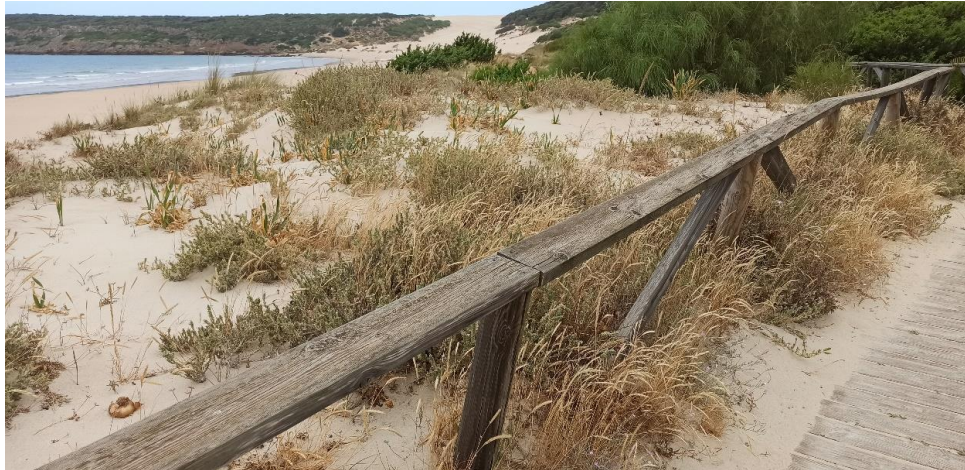
Ilustración 10. Pasamanos de pasarela en mal estado.
