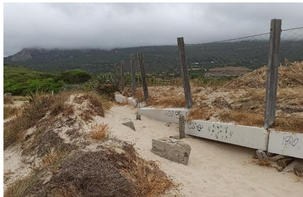
Ilustración 8. Cerramiento deteriorado debido a la erosión marina.
