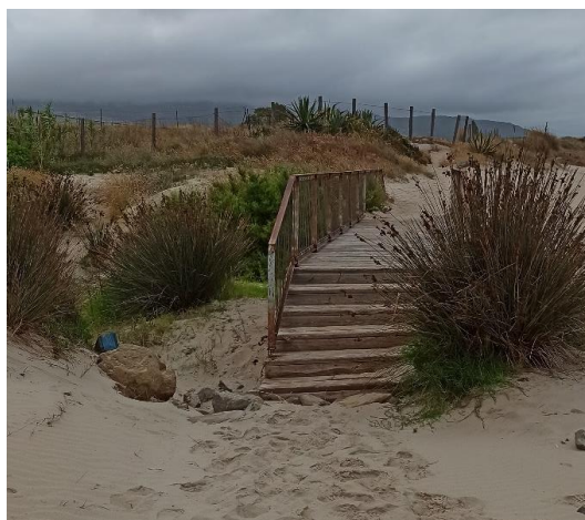
Ilustración 9. Puente con daños por erosión marina.
