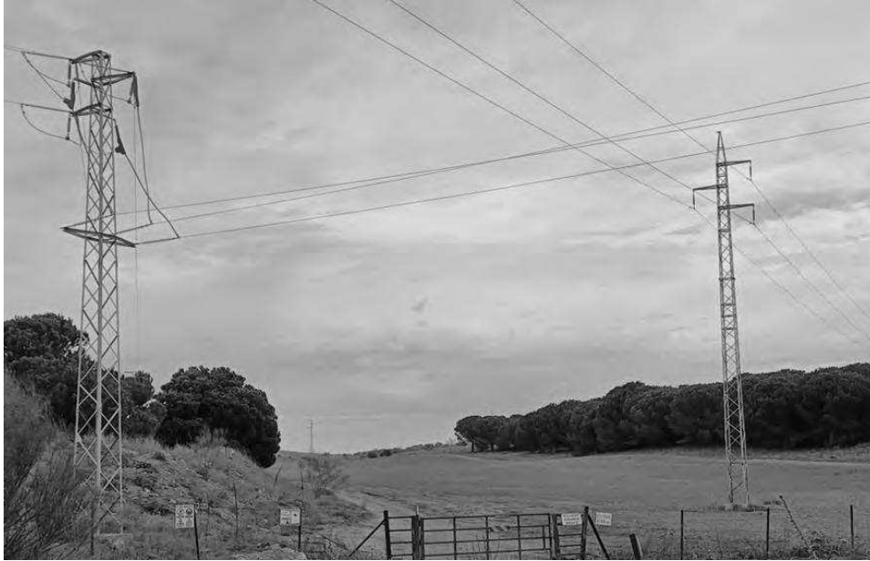
Figura 61. Tendido eléctrico Bornos-Villamartin
