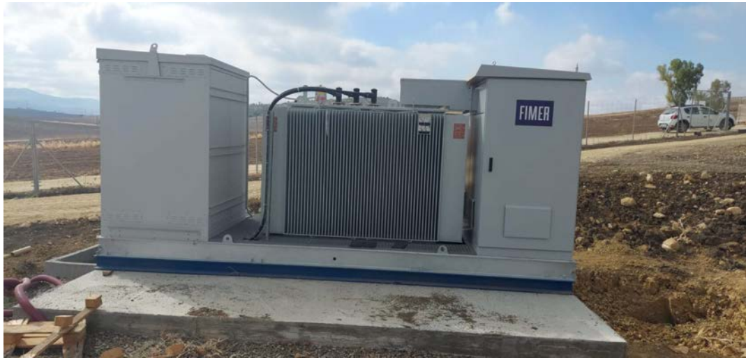
Vista de un centro de transformación prefabricado compacto intemperie
