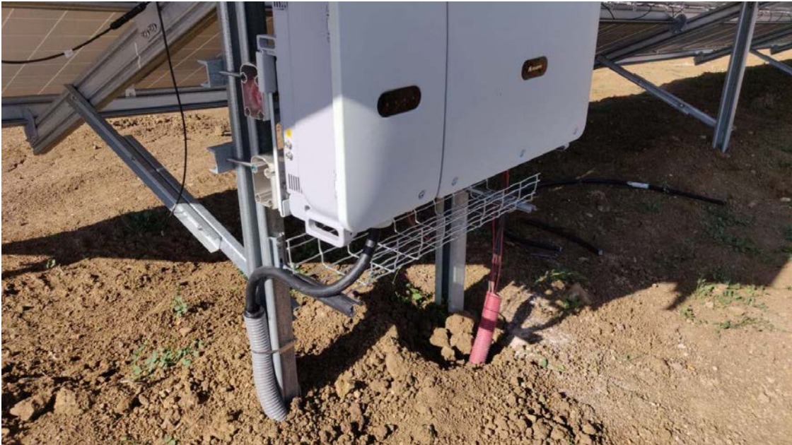
Ejemplo de protección mecánica
