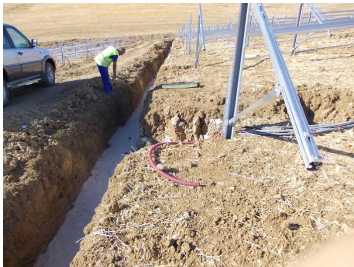
Ejemplo de zanjas para cableado AC
